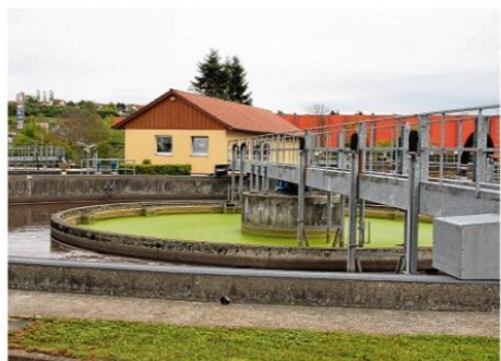
Für die bauliche und technische Errichtung der Kläranlage Pfulleendorf muss der Eigenbetrieb „Abwasserbeseitigung“ wieder hunderttausende Euro investieren. BILD: SIEGFRIED VOLK
